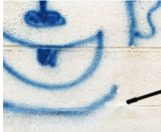
Jos suojattu pinta on graffitien tahrima, puhdista se suurpaine- ja höyrypesurilla. Levitä sen jälkeen uudelleen PROWALL II:ta puhdistetuille alueille.
