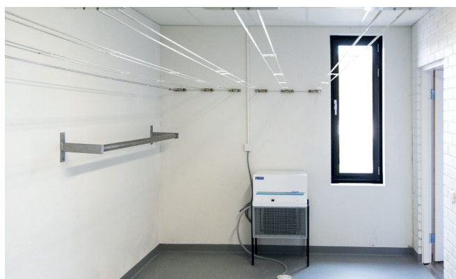
Kuivaushuone, kuivauspuhallin Contra 2000 Turbo, kuivauskone Contra 2000 Turbo, ripustusjärjestelmä Ripa ja mattotanko MT 200.
