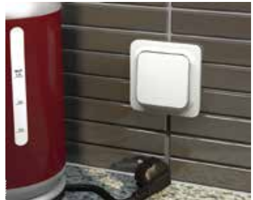
Vanha asennus, jonka paikalle tarvitaan uusi pistorasia.
