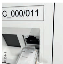
P120549 Liittimet käännetty johtojen irrottamisen helpottamiseksi.
