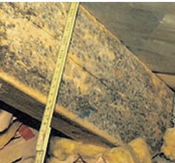
Homeen vaurioittamat kattopalkit.
